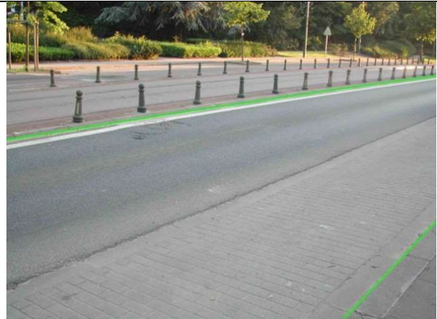
De rand die de buitengrens van de rijbaan markeert die gemeenschappelijk is met de vrije baan voor het openbaar vervoer (eigen bedding), wordt voorgesteld in de laag « BR0101L »
