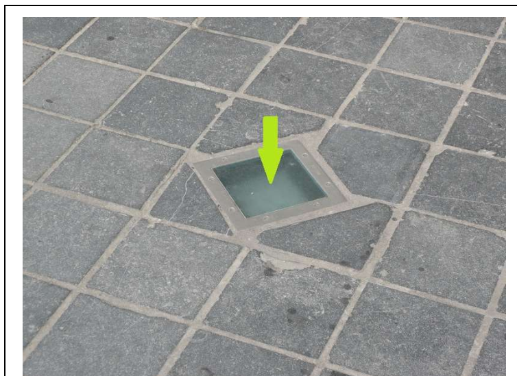
De in de vloer ingebouwde verlichtingsarmaturen worden voorgesteld in de laag « CR32P » door middel van het niet-georiënteerde symbool « CR3202P ».
