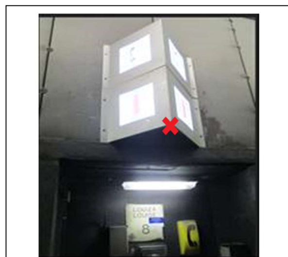
Les plaques de signalisation de niches sont représentées dans la couche « 830_Signal_niche ».
